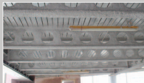
Application de Grace Monokote ® MK-6 sur les poutres cellulaires permettant un espace maximal pour les gaines électriques et techniques.
